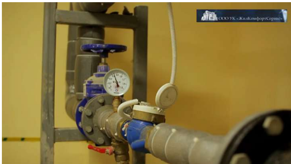
Система удалённого контроля системы теплоснабжения и подачи горячей воды
