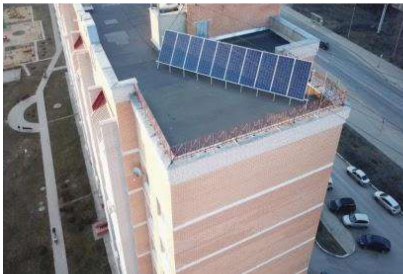
Солнечные панели на крыше дома
