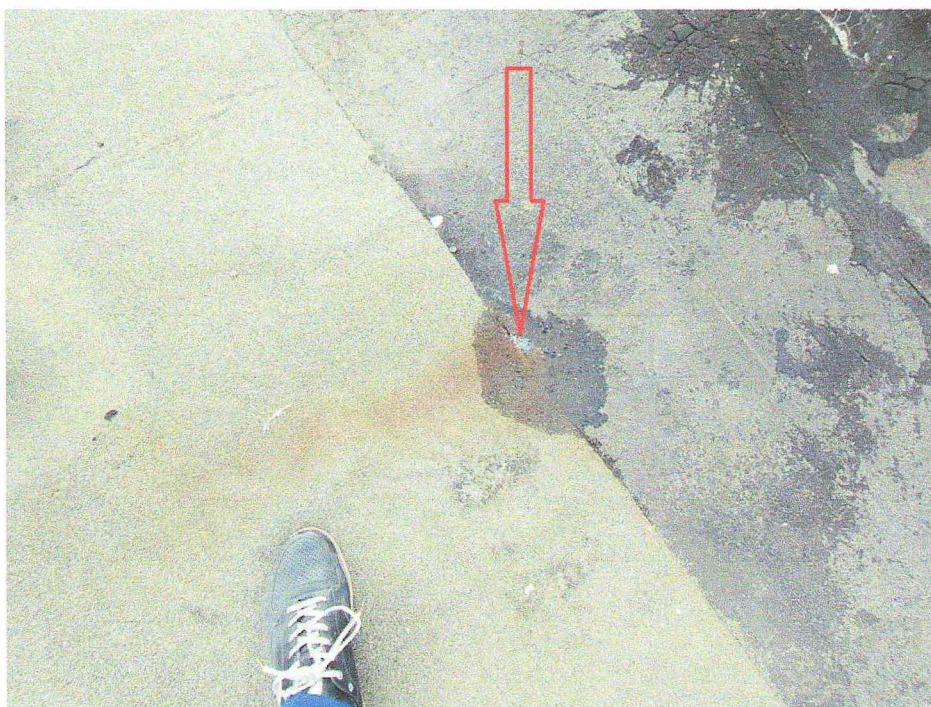
Фото №13. Наличие воды под покрытием при давлении (нажатие ногой).
